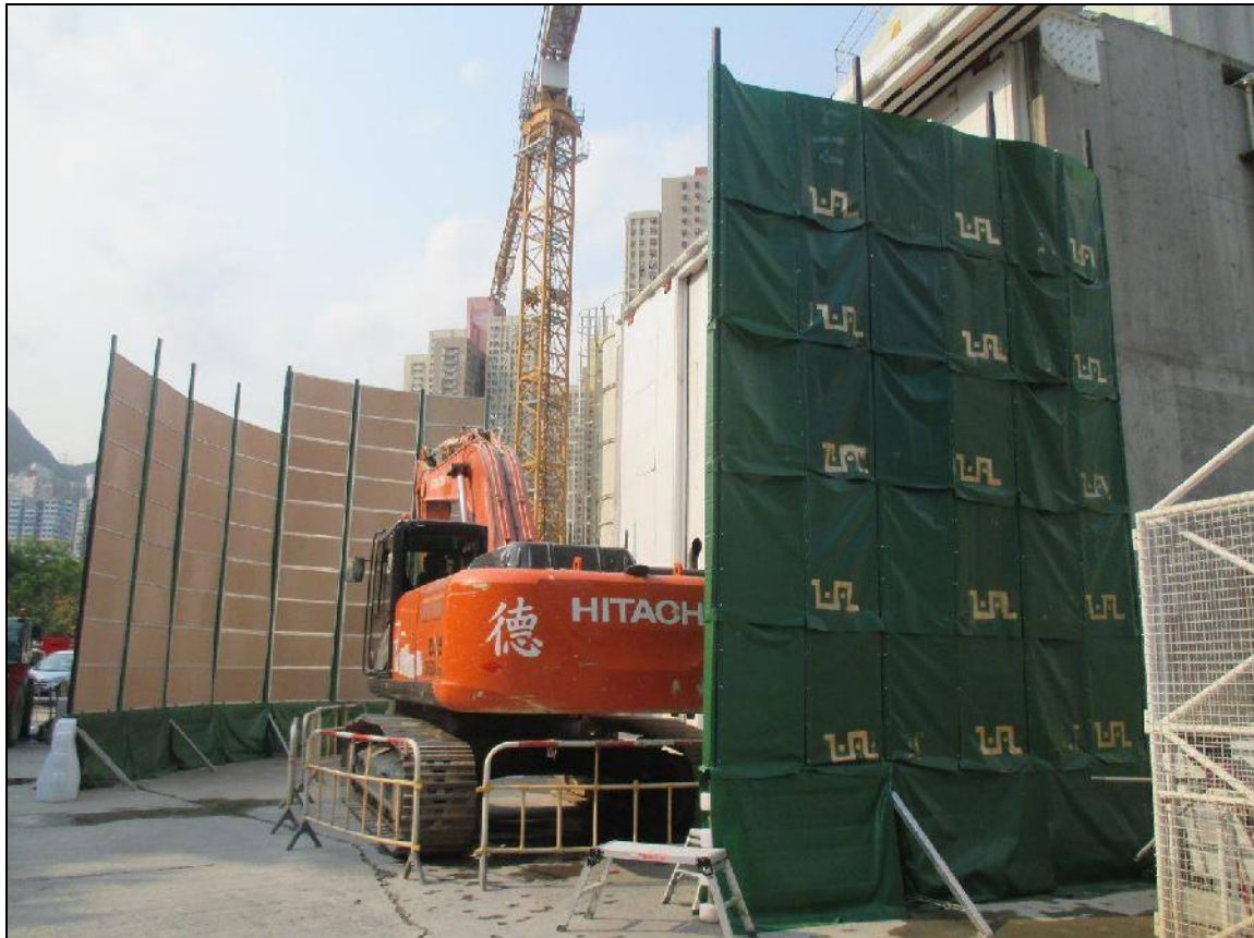
Εικόνα 9-2: Χρήση ακουστικών ηχοπετασμάτων γύρω από την περιοχή όπου πραγματοποιούνται εργασίες από εκσκαφέα και προκαλούνται υψηλά επίπεδα θορύβου
