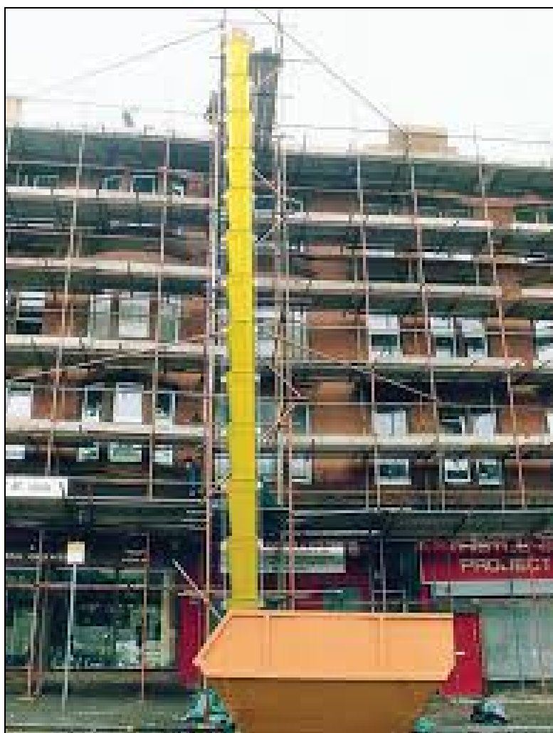
Εικόνα 9-7: Σωλήνας μεταφοράς σκουπιδιών (waste chute)
