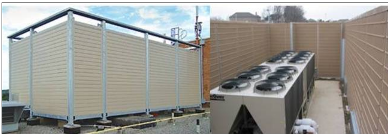
Εικόνα 9-8: Συστήματα VRV εντός ηχομονωτικής περίφραξης σε οροφή κτηρίου
